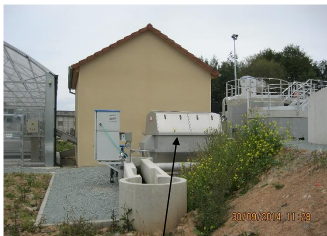
Filtration de la station d'Anjouey
