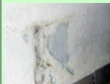
Dégradation du revêtement en raison de la persistance d'humidité en bas du mur
