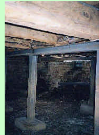
Aucune dalle béton n'a été réalisée dans le sous-sol de cette habitation. Cette partie du bâtiment est "sacrifiée à l'inondation".
