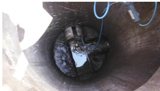
Point de mesure équipé d'une sonde hauteur vitesse et d'un enregistreur
