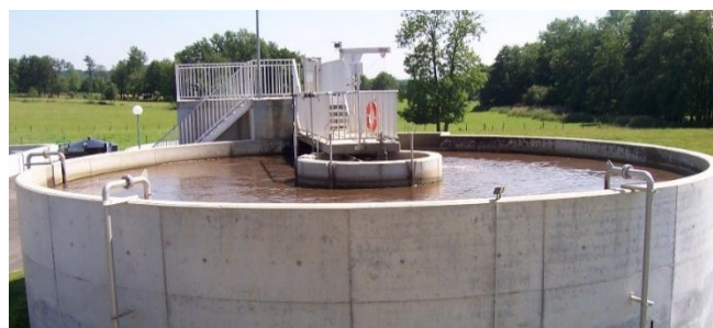
Station d'épuration – Lachapelle-sous-Rougemont mise en service mars 2007.
