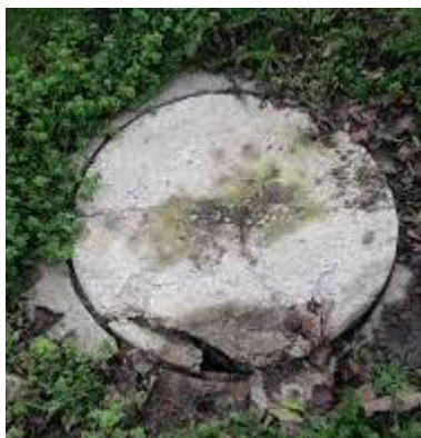
Tampon de fosse fissuré
